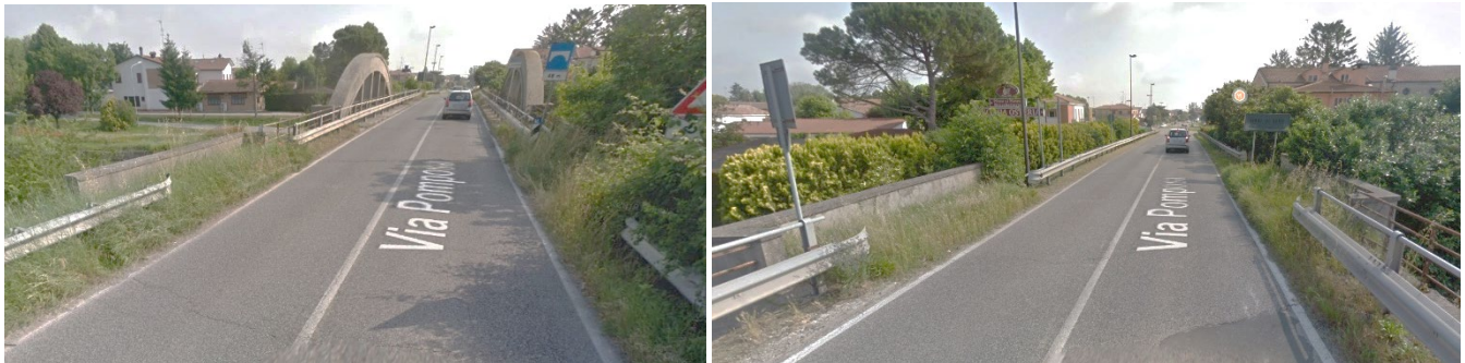
Foto 4 e Foto 5 – Assenza di barriera di sicurezza su ambo i lati della carreggiata in approccio al ponte
