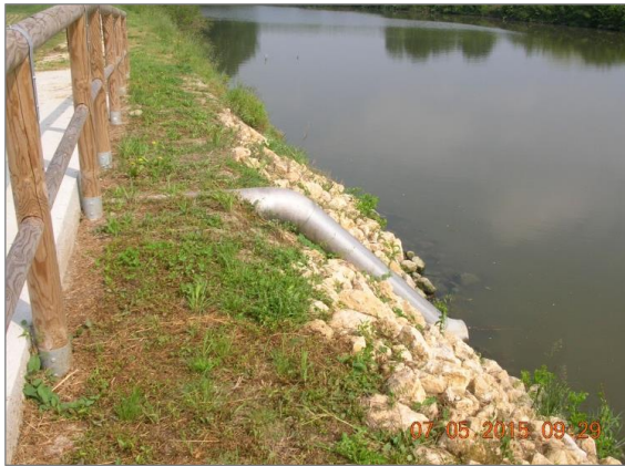
Figura 53 – Collettore di scarico dell'impianto di depurazione
