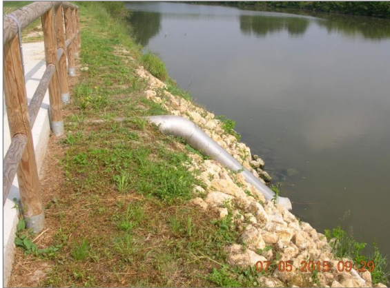
Figura 1 – Collettore di scarico dell'impianto di depurazione
