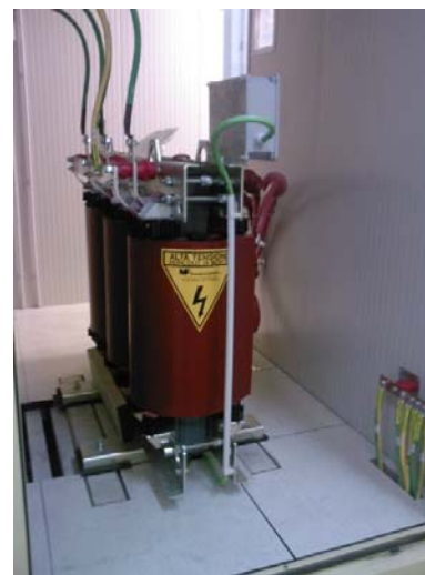
interno shelter 1 trasformatore servizi ausiliari
