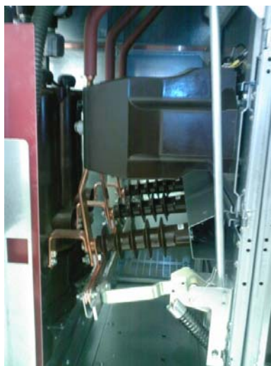
interno shelter 1 interno cella partenza gruppo di conversione
