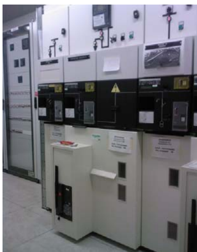
interno shelter 1 da sx a dx cella dispositivi generali, cella misure di sbarra, cella partenza gruppo di conversione
