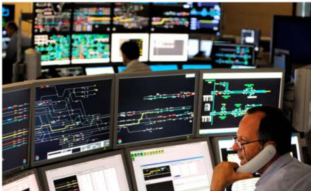
Sala supervisione circolazione di Bologna
