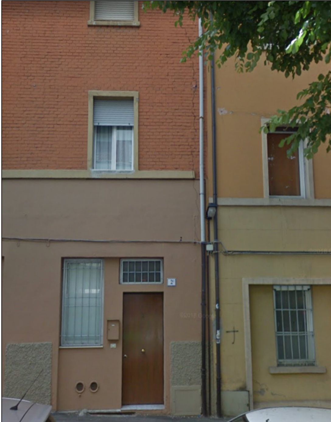
Dettaglio fessure in corrispondenza del confine con l'adicente fabbricato in via Bentivogli 4
