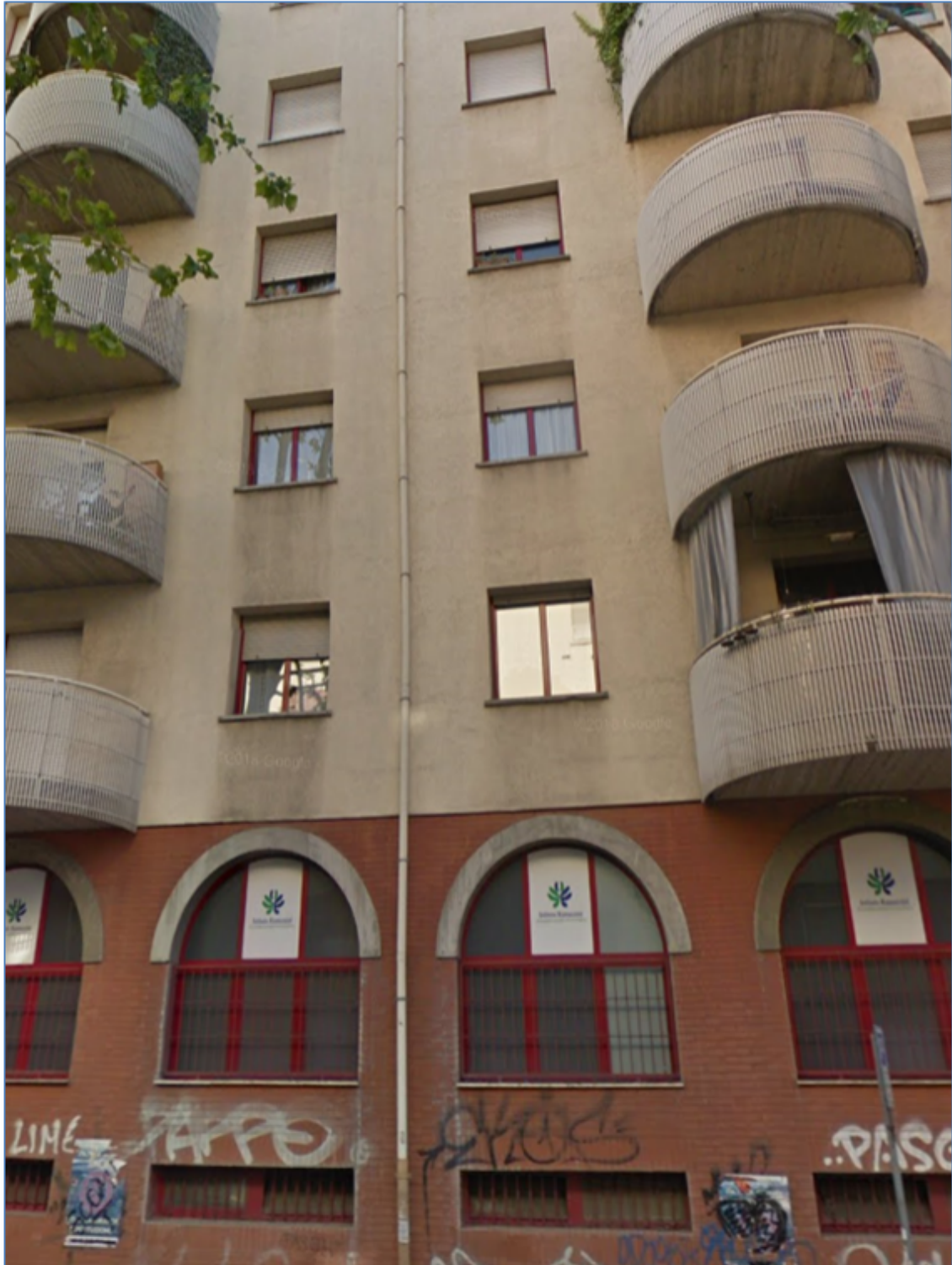
Dettaglio logoramento balconi e facciata principale su via Libia
