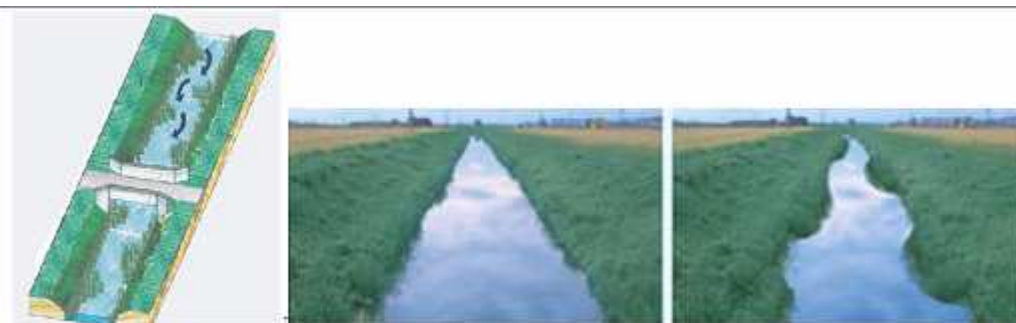
Figura 3.3 - Creazione di canale di corrente sinuoso con l'asportazione parziale della vegetazione erbacea (da PTA provincia di Bologna)
