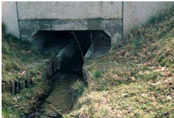
Figura 1.14 - Esempio di eco-culvert con passerelle laterali per fauna di piccole dimensioni- Infra Eco Network Europe
