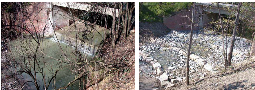
Figura 2.6 - Esempio di costruzione di rampa in pietrame in Valsellustra (Pianificazione e realizzazione di metodi integrati per il recupero del bacino idrografico della Val Sellustra LIFE00 ENV/IT/000065 Comune di Dozza Newsletter n°6).
