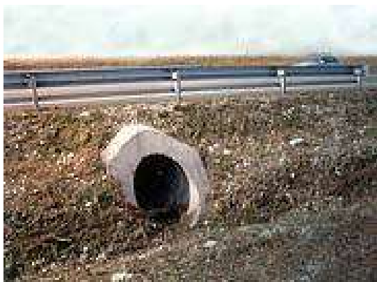
Figura. Esempio di sottopasso faunistico, non completamente funzionale, per piccola media fauna (da Infra Eco Network Europe).
