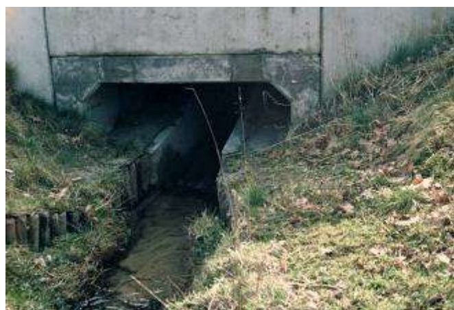
Figura. Esempio di Eco-culvert con passerelle laterali per fauna di piccole dimensioni (da Infra Eco Network Europe).
