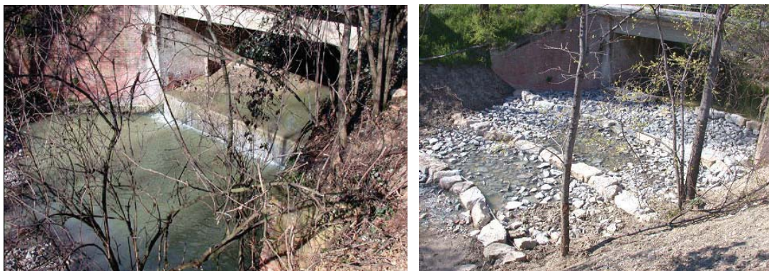
Figura 0.32 - Esempio di costruzione di rampa in pietrame in Valsellustra (Pianificazione e realizzazione di metodi integrati per il recupero del bacino idrografico della Val Sellustra LIFE00 ENV/IT/000065 Comune di Dozza Newsletter n°6).
